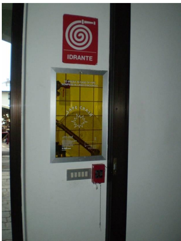
INGRESSO EDIFICIO (piano terra): Idrante a muro UNI 45
