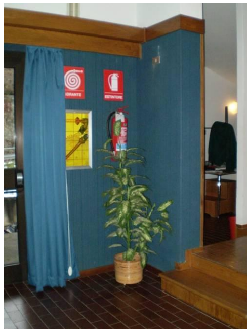
SALA CONGRESSI (piano terra): Idrante a muro UNI 45 Estintore 6 Kg polvere 34°144BC
