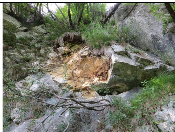
Foto 1 – Dettaglio della zona di distacco
