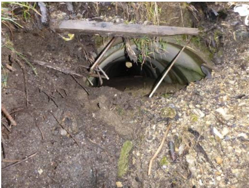
Particolare ostruzione tubo al disotto del parcheggio P 5
