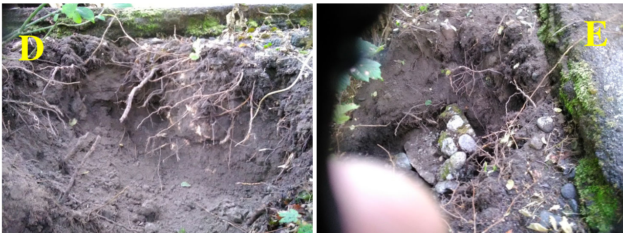
D ed E) pozzetto P3 presso la zona con fessurazioni del manto stradale con evidenze del cordolo in blocchi realizzato sopra il substrato roccioso
